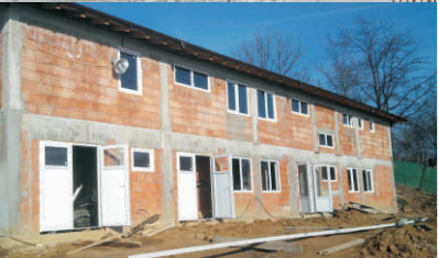
Fotografii din timpul lucrărilor de construire, extindere și modernizare a stațiilor de epurare din Râmnicu Vâlcea, Băbeni, Călimănești și Olănești
